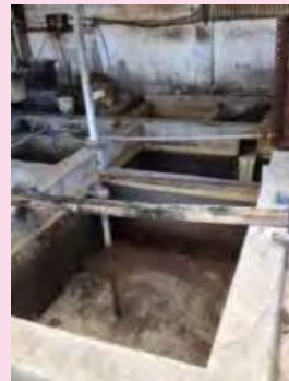
既存の排水処理槽
